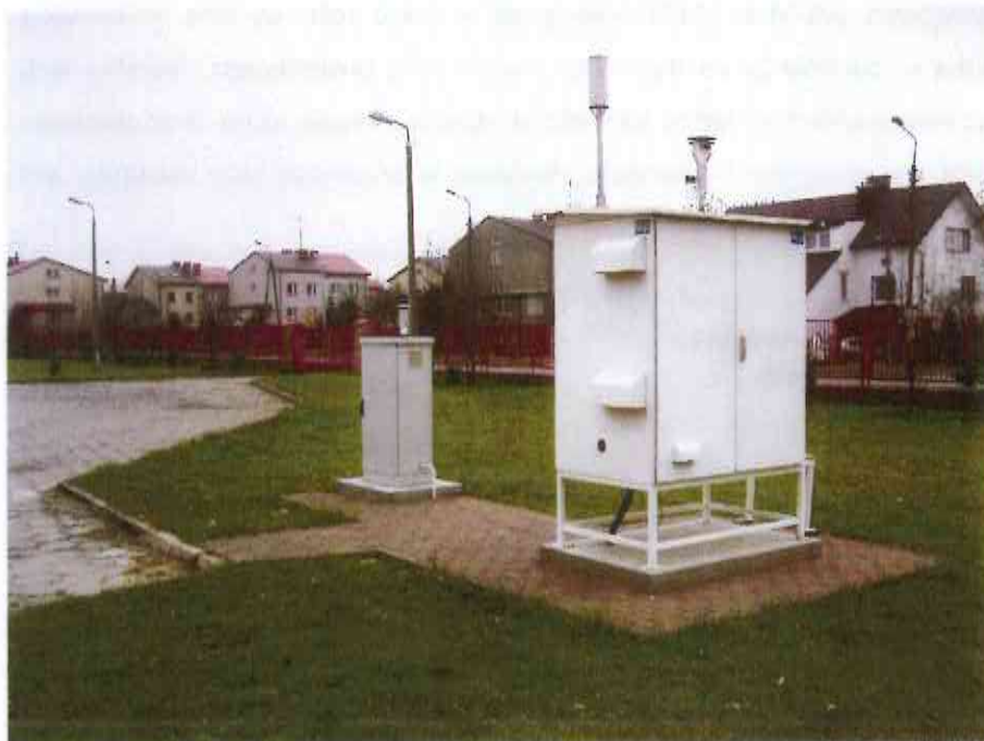
Fot. 1. Zmodernizowana w 2010 roku Stacja monitoringu zanieczyszczenia powietrza atmosferycznego przy ul. Sikorskiego 94/98 w Łomży
