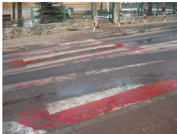
Fot. 37. Plac Kościuszki - zły stan oznakowania poziomego przejścia dla pieszych
